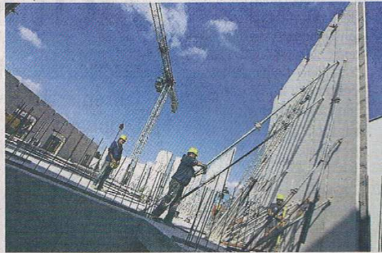
Die ersten Wände der neuen Moschee stehen bereits. Im November soll der Rohbau fertig sein. Fotos (2): Sergej Lepke
